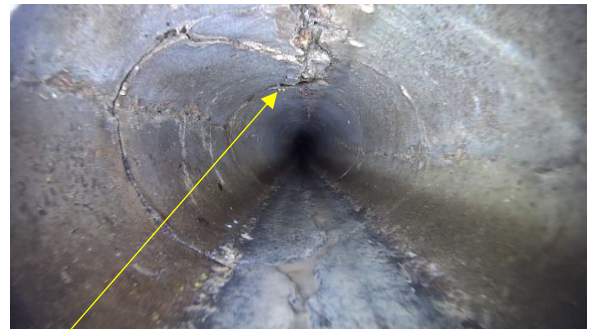
ヒューム管の破損、浸入水
